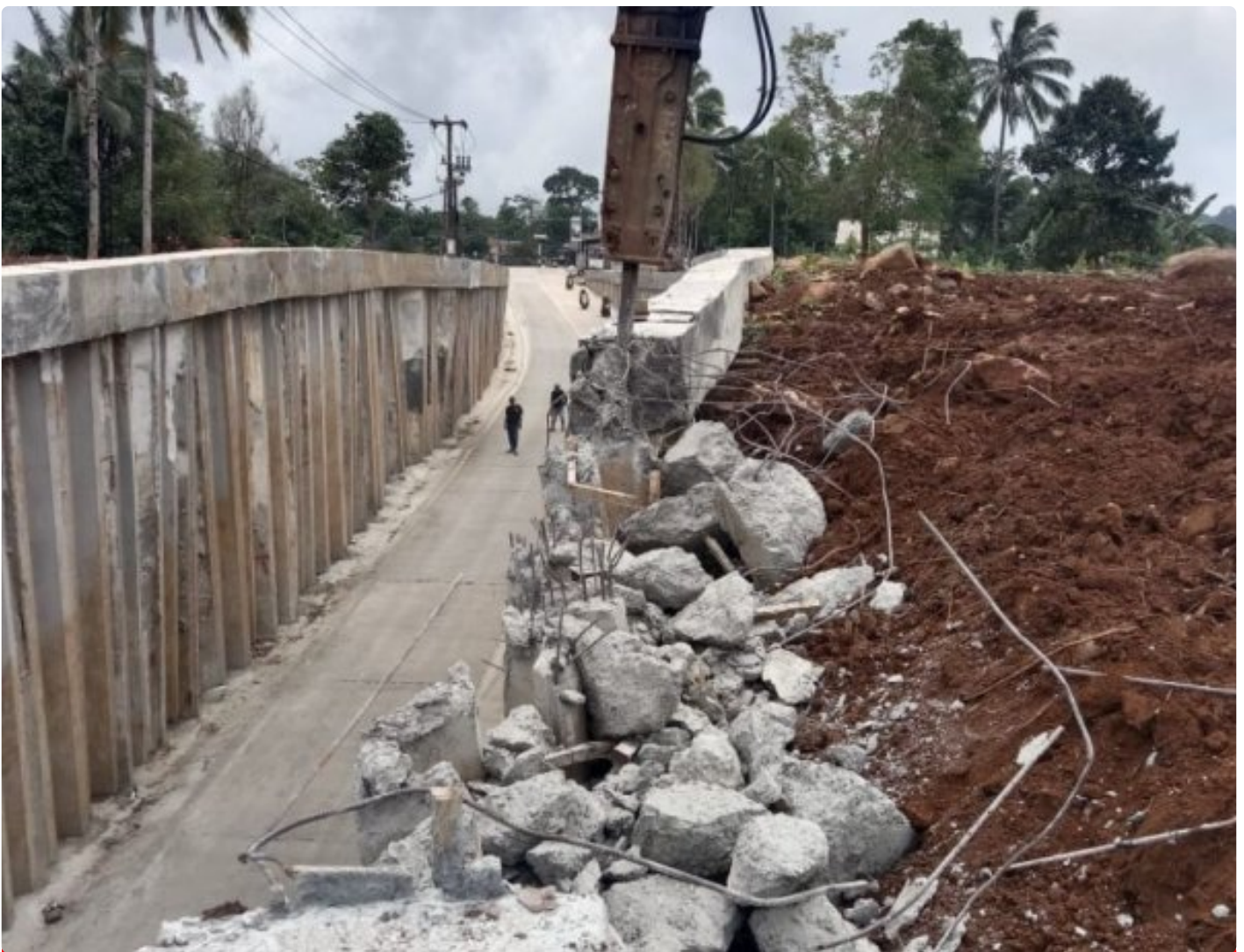
Diduga Proyek Gagal Kontruksi
